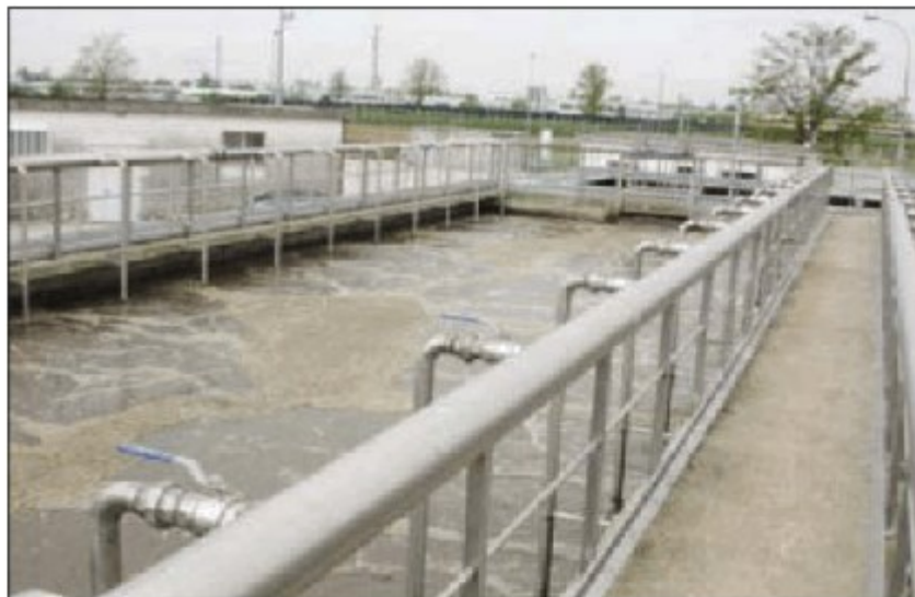
Un impianto di depurazione delle acque reflue
