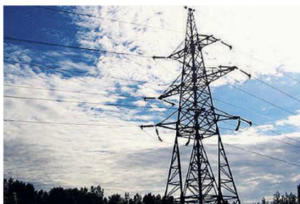
Traliccio. L'opera rientra nella razionalizzazione della rete dell'alta tensione
