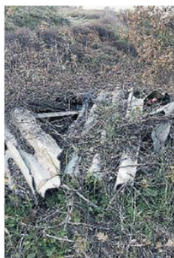
La discarica. Le lastre d'amianto sono coperte da erbacce
