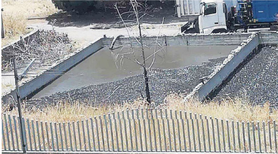
Depuratore. Ecco un'immagine delle vasche a servizio dell'impianto ubicato nel quartiere a Sud della città e preso di mira dai cittadini
