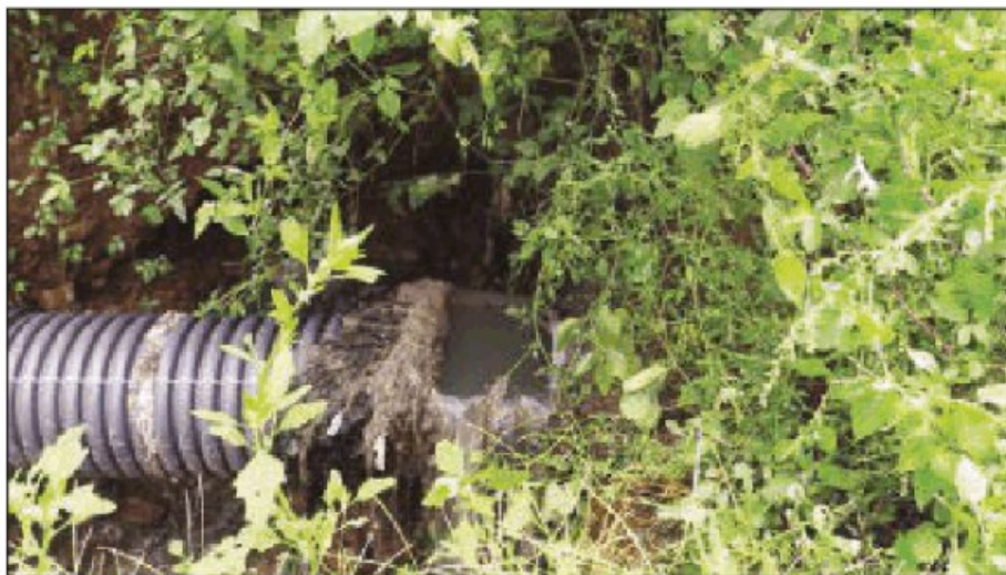
La condotta nel punto dove presenta il taglio che causa lo sversamento di fogna nel torrente
