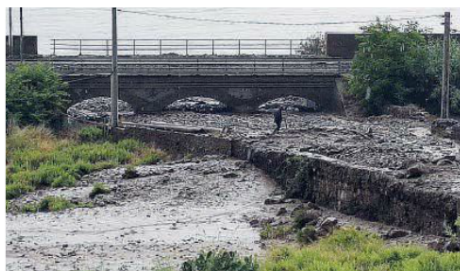
Ex cava Musella. Molti detriti sotto il ponte ferroviario a Scilla
