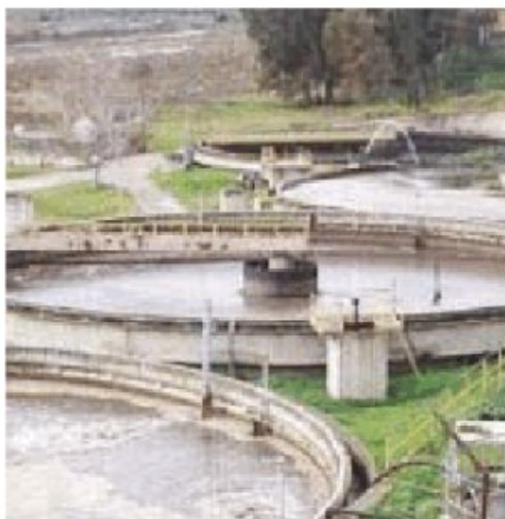
Un impianto di depurazione
