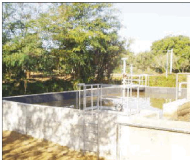
Il depuratore di Girifalco
