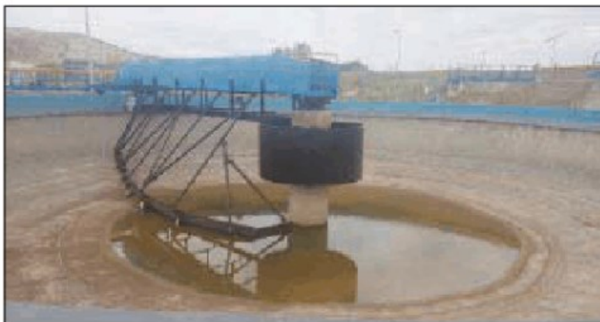
Il depuratore comunale
