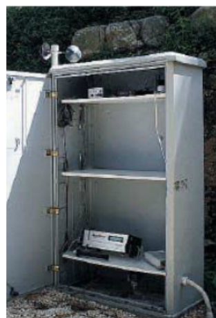
Centralina di misurazione. Via all'installazione a Borgia
