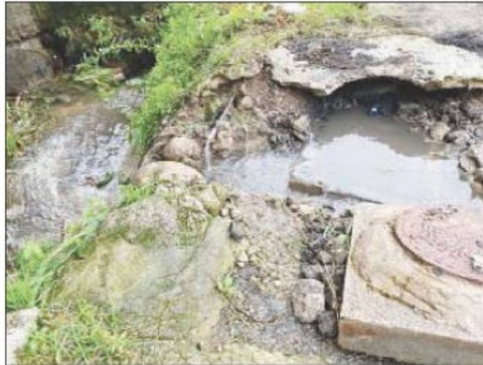
La fogna che fuoriesce dall'impianto del metano
