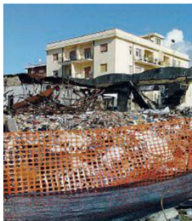
Scempio ambientale La struttura ancora in attesa di essere abbattuta
