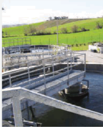
Un impianto di depurazione
