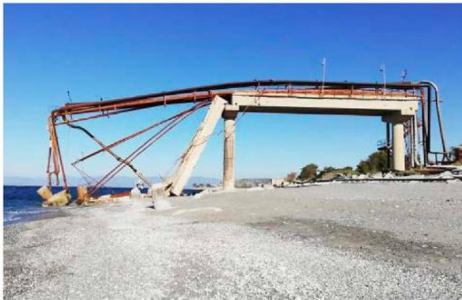
Il pontile crollato Il pericolo per l'incolumità è di tutta evidenza
