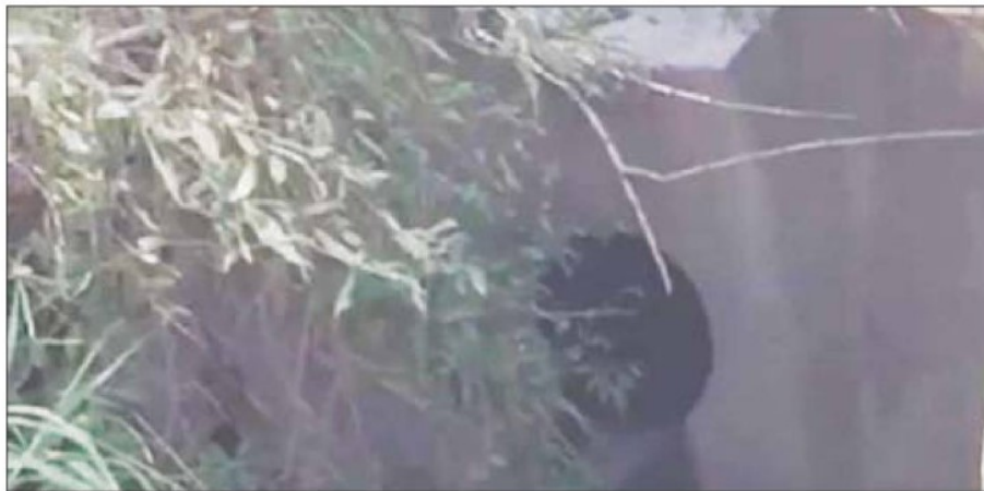
La fuoriuscita dei liquami
