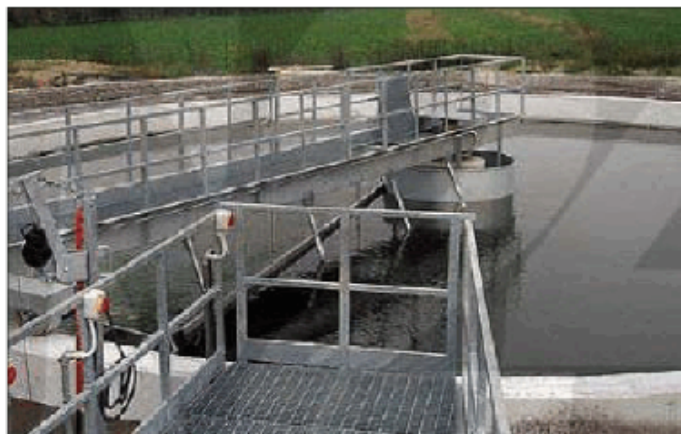
L'impianto di depurazione di Lido Sant'Angelo
