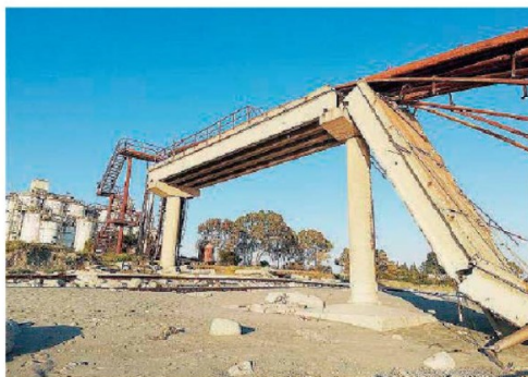
Degrado Una struttura pericolante nell'area dell'ex Liquichimica
