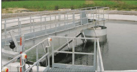
Un impianto di depurazione
