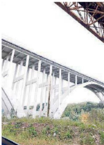
Ponte Petrace Il pilone centrale lungo il quale i liquami finiscono nel fiume
