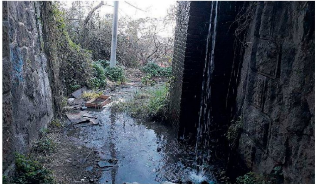
Una cloaca all'aperto Le condizioni della stradina che passando sotto il ponte della ferrovia conduce verso il mare
