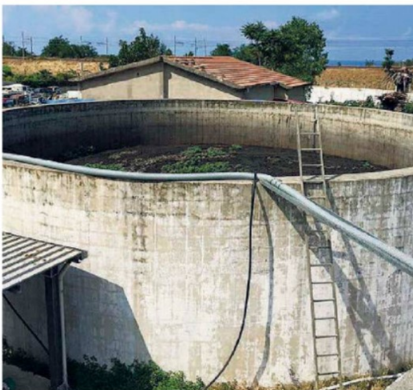
Emergenza Una delle vasche del depuratore di Paola
