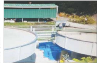
Il depuratore ubicato in contrada Maddalena
