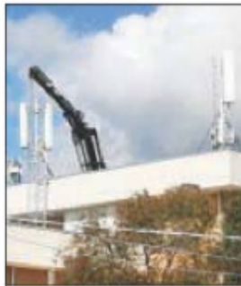
Antenne per la telefonia
