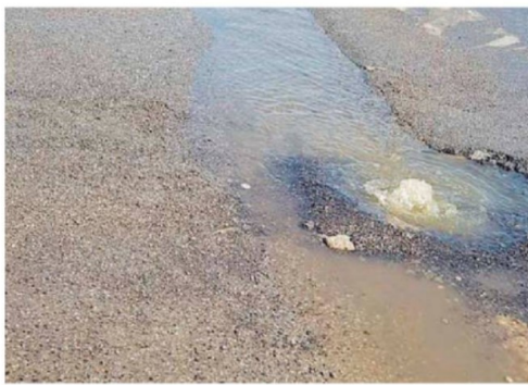
Un torrente di fogna. Ennesima rottura sulla condotta in via delle Industrie
