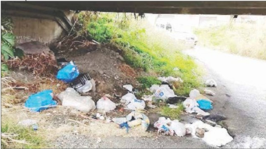
Rifiuti abbandonati sotto il Ponte Oliva
