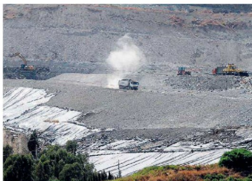
Controlli La discarica di Alli sarà oggetto di verifiche approfondite
