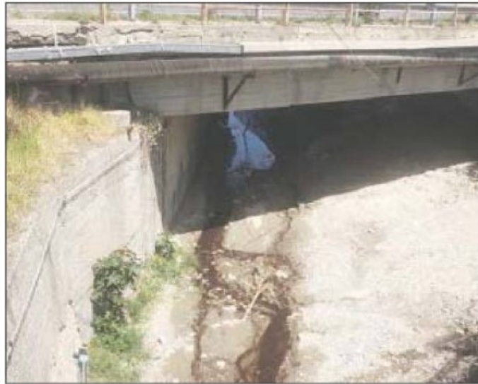
La perdita di liquami in località Pilati
