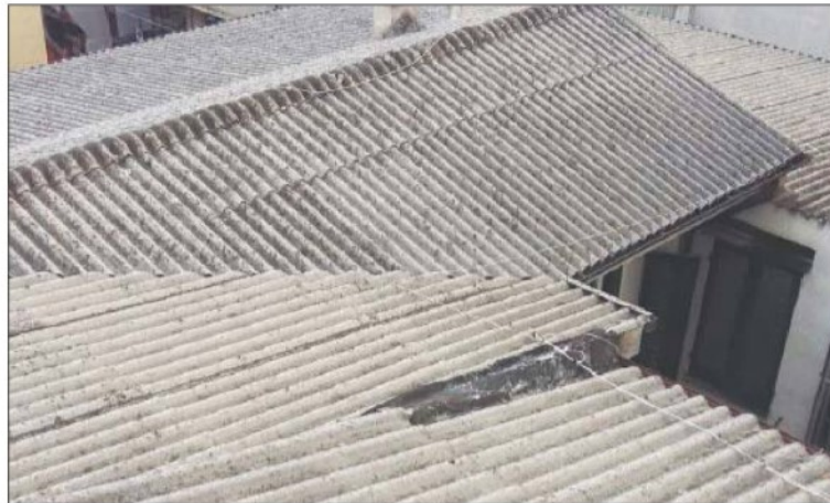
Tetti di abitazioni con amianto
