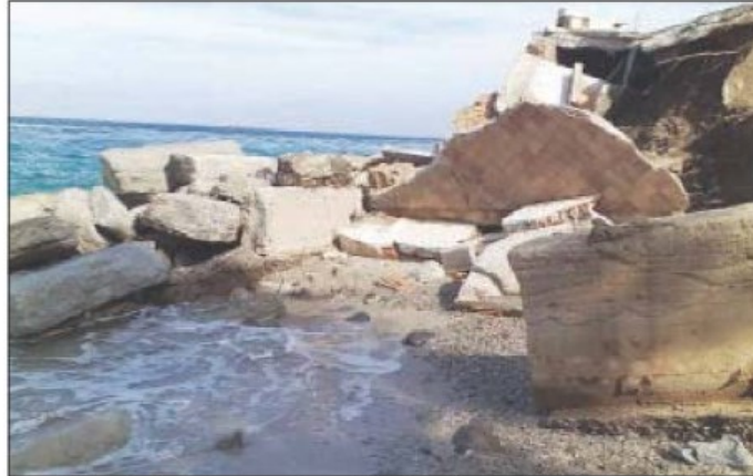
Danni dovuti all'erosione costiera a Villa San Giovanni
