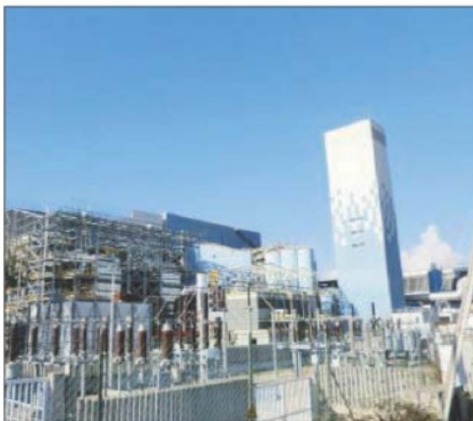
Il termovalorizzatore di Gioia Tauro
