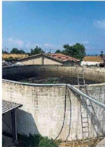
Depuratore Per l'impianto sono arrivati fondi per 4 milioni e mezzo di euro
