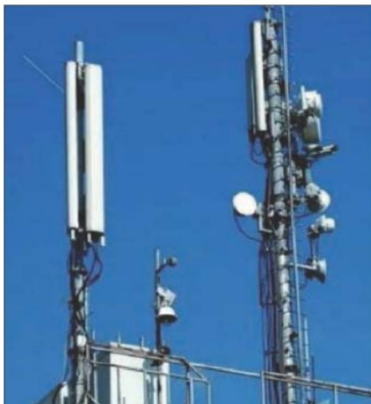
Delle antenne per la telefonia mobile
