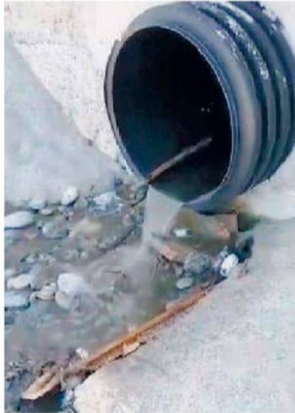
Bagnara Calabria La fuoriuscita di liquami fognari in spiaggia
