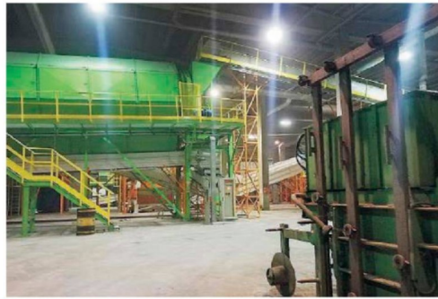
Sotto la lente L'interno dell'impianto di selezione dei rifiuti a Ponticelli
