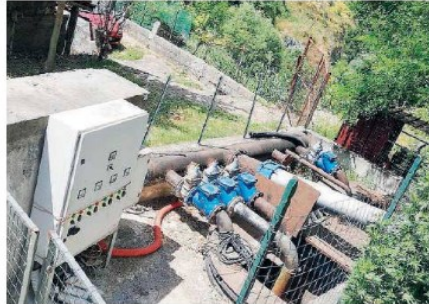
La stazione di sollevamento L'impianto ormai è insicuro e pericoloso
