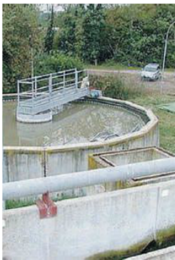
Depuratore da sistemare. Al fine di scongiurare problemi in estate
