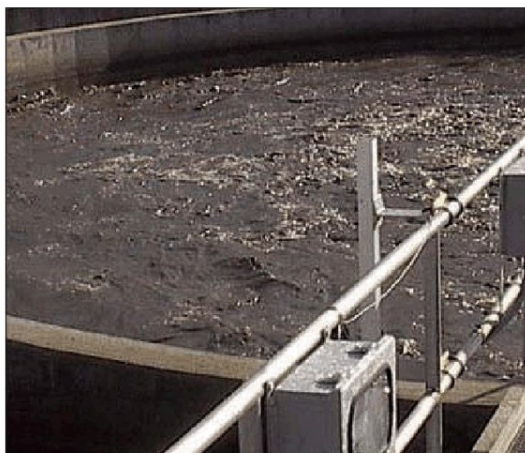
Una vasca di depurazione di un impianto
