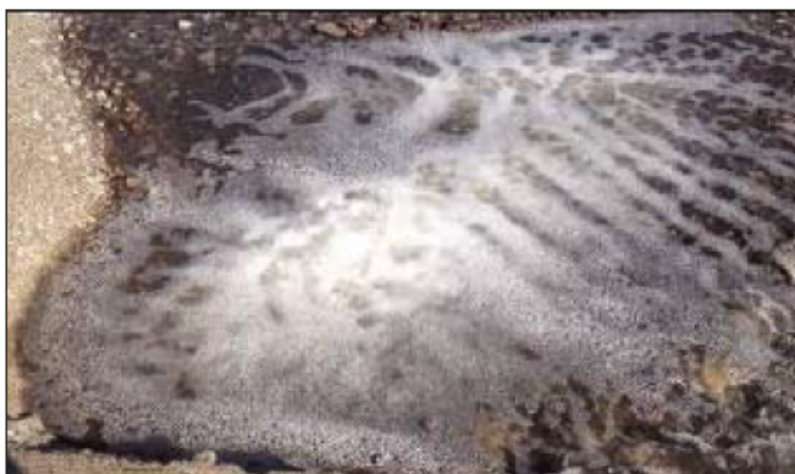
La perdita della tubazione del depuratore
