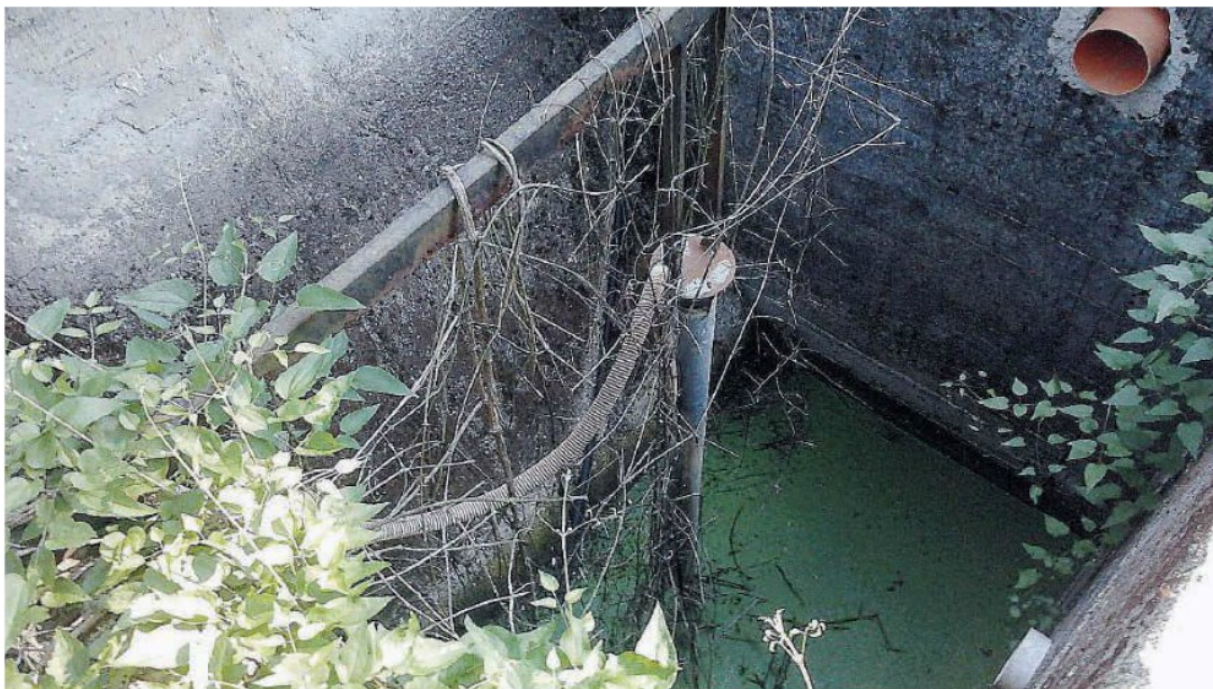
Depuratori in abbandono. “Nuova Borgia” fa riesplodere il caso dei due depuratori dismessi e del rischio di eventuale inquinamento delle falde acquifere
