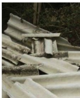
Lastre di eternit. L'amianto che contengono è pericoloso
