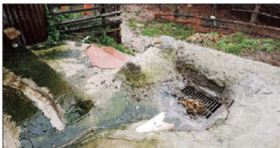
Un tombino in cui confluivano le acque reflue non filtrate
