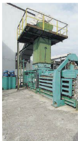
Impianto di Alli
