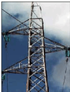
Un traliccio dell'Enel
