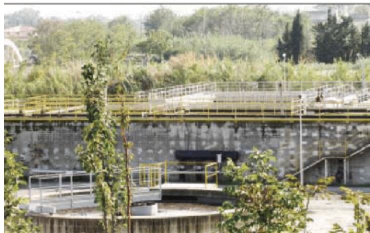
Il depuratore consortile di Isca sullo Ionio
