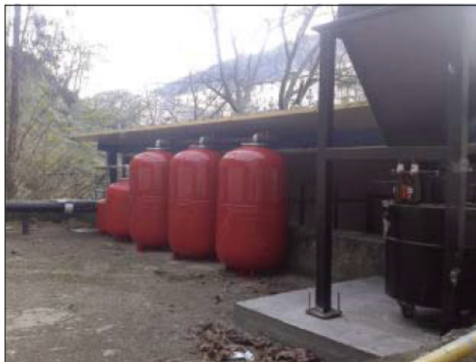
Uno dei cogeneratori finiti nel mirino del gruppo "Per Longobucco"
