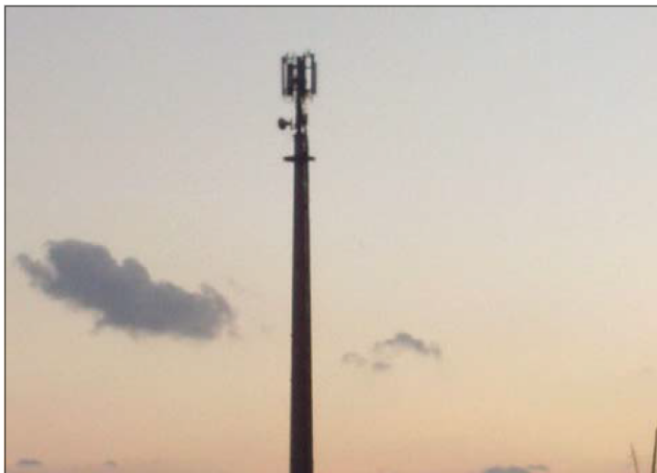
L'antenna di telefonia mobile realizzata dalla Ericsson e che probabilmente dovrà essere smantellata
