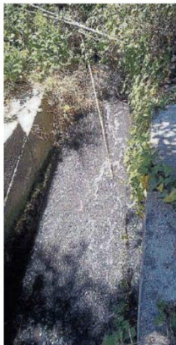
Reflui non depurati. Rilevati dalla GC in uscita dall'impianto
