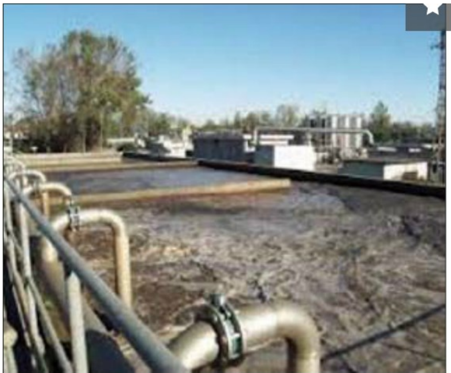
Un impianto di depurazione
