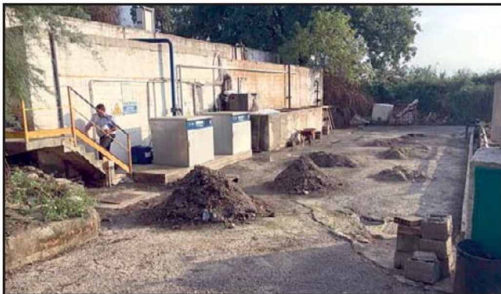
L'impianto di depurazione di Belvedere Spinello
