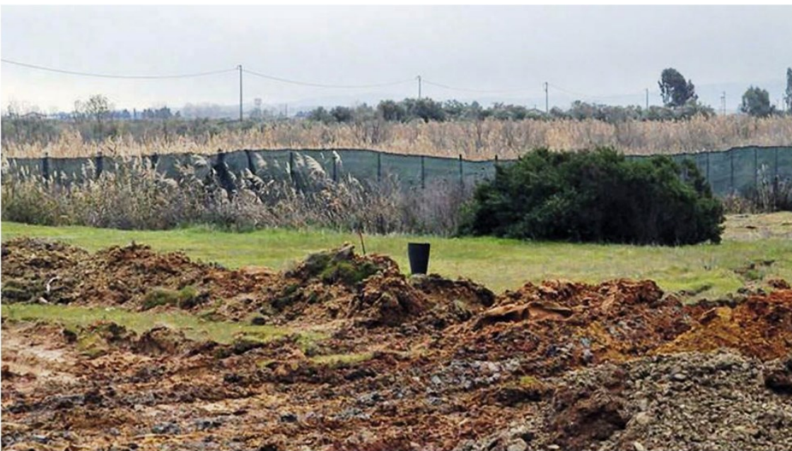
Uno dei terreni in cui furono scoperte le ferriti di zinco. Dopo la recente bonifica la preoccupazione è ancora tanta
